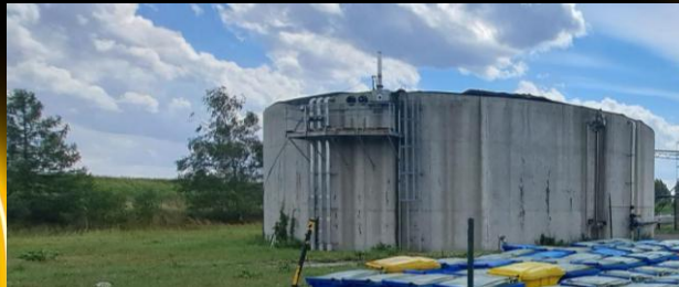
BPS Vsebořice – skladová jímka
